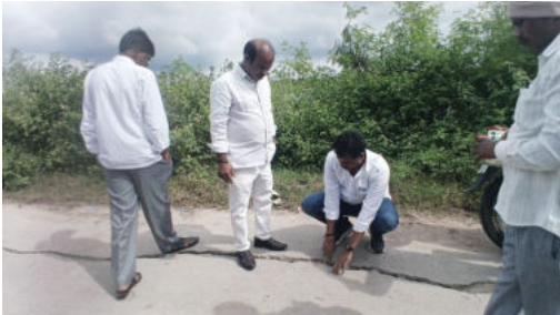
ముదిరెడ్డి చెరువు కట్టపై పగుళ్లను పరిశీలిస్తున్న ఇబ్రహీంపట్నం ఇరిగేషన్ శాఖ డి ఈ నల్గొండ ఆంజనేయులు
